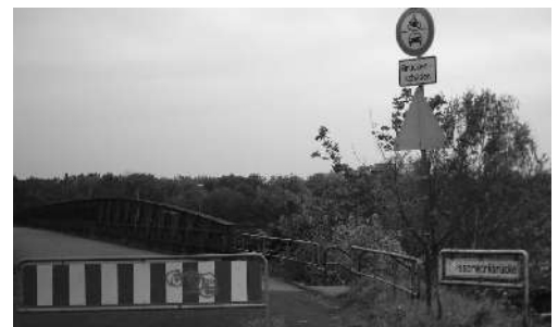
Sanierungsfall Wasserwerksbrücke Foto: Wolfgang Melchert
